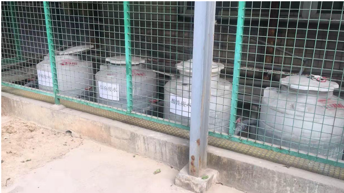
图 7.1-2 废水分类收集罐照片
